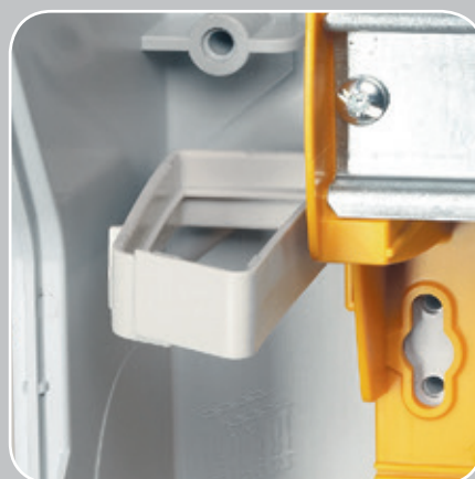
▲ Bracelet permettant le guidage des câbles
